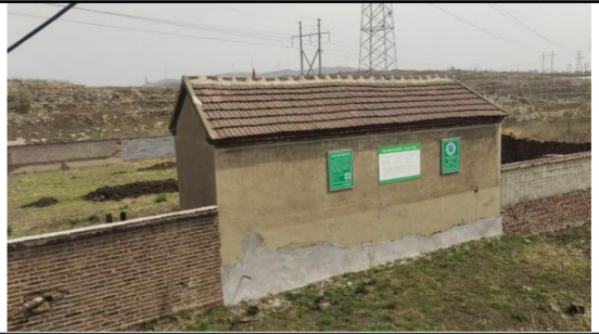
大黑山后村西北侧配电值班室
