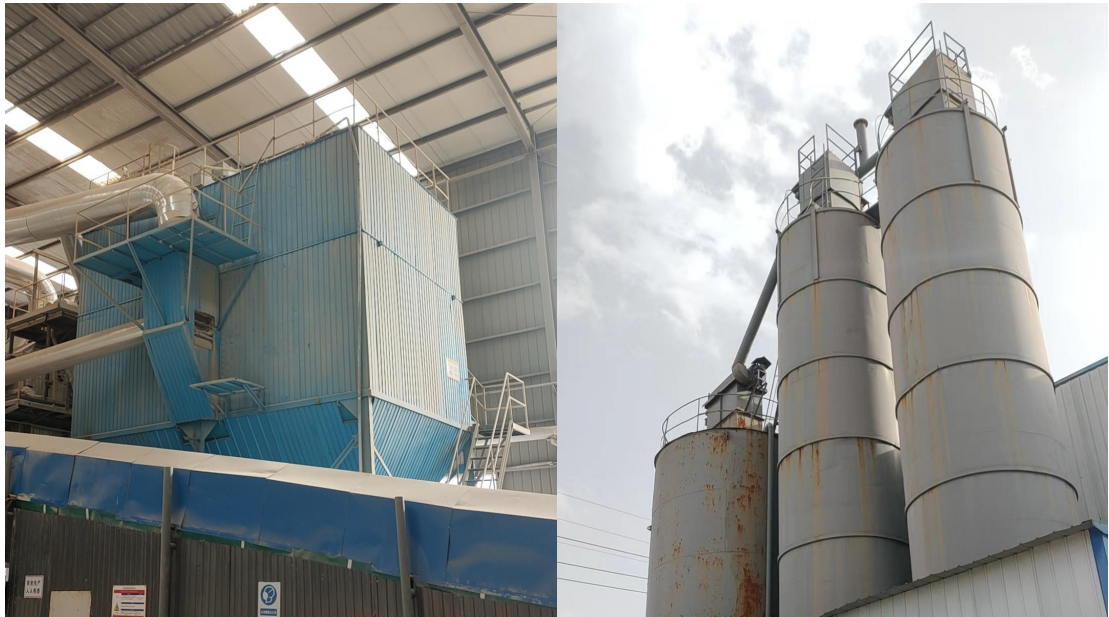
图 6-5 建筑石膏项目除尘设备
